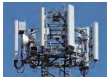
Estación base de comunicaciones
